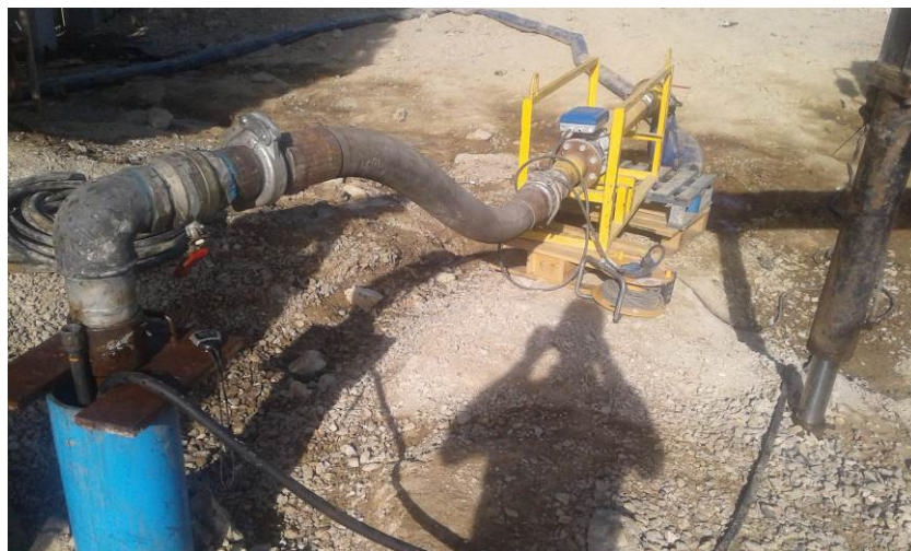
Figure 12 - Dispositif de pompage
